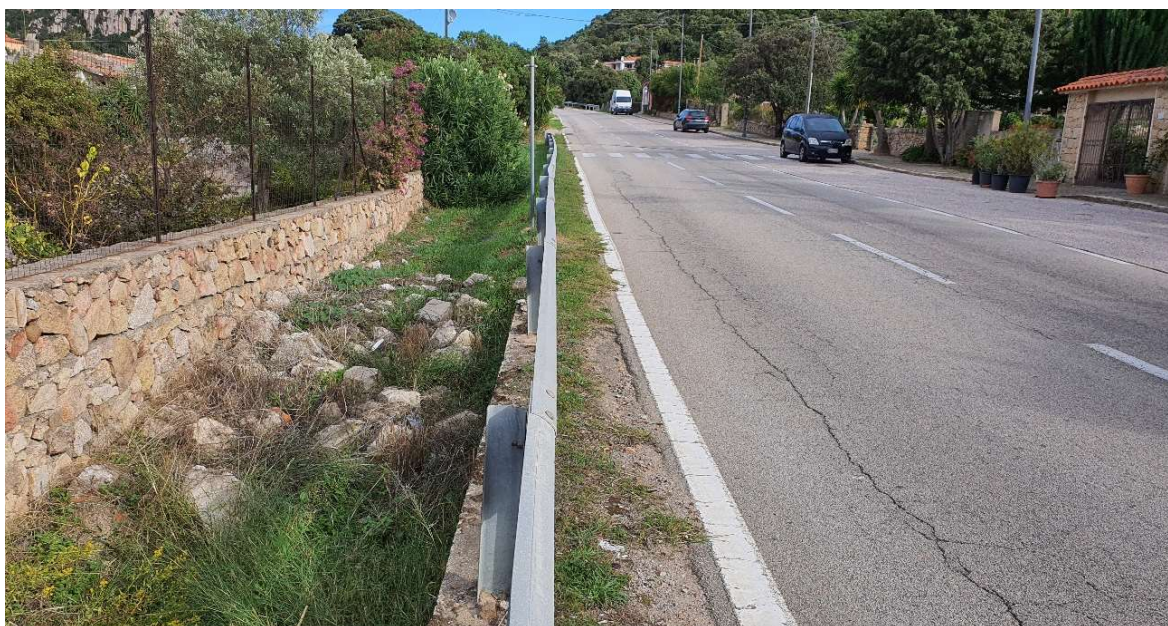
Fig. 3 – Via del lato destro (nord) di via Zara – (tratto 4a)
