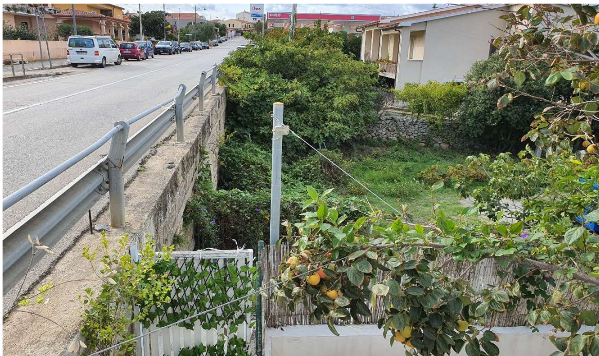
Fig. 5 – Immagine della depressione del terreno in corrispondenza del ponte esistente su via Zara (compluvio – Tratto 2)
